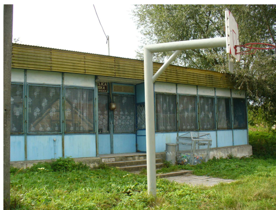
Fot. 79. Świetlica wiejska wymagająca remontu w Czesławicach
